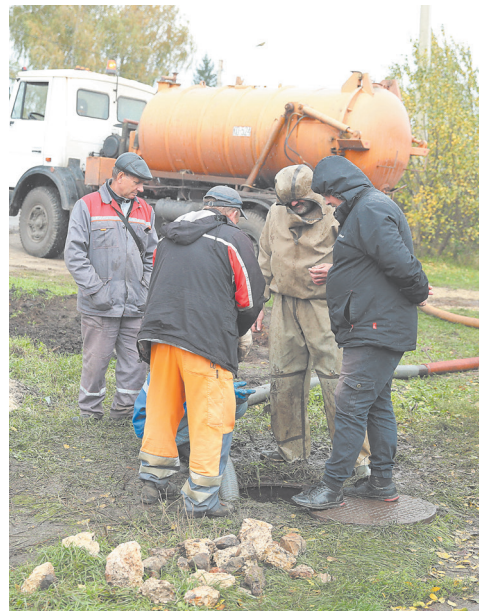
Для устранения утечки на водоводе Д-76 мм у дома № 26 временно была отключена холодная вода
